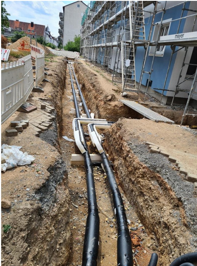
Nahwärmeleitung mit Abzweig
