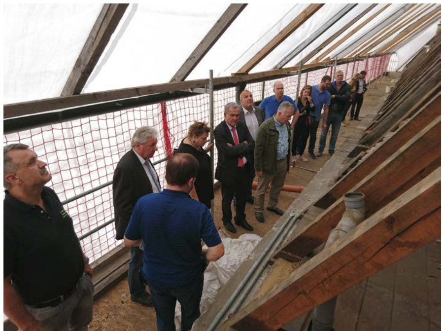
Im Anschluss konnten sich die Stadträte dann vor Ort von den Bauschäden und der Notwendigkeit zur Sanierung überzeugen.
